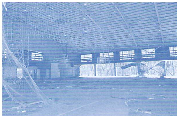
ステージが流された体育館
